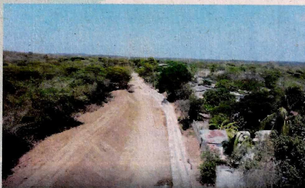
Estado actual del Canal de Aguas Lluvia El Pantano.
