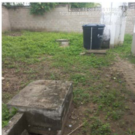
Imagen 2 Poza séptica donde llegan aguas residuales domésticas generadas del Puesto de salud de Villa de Rosa
