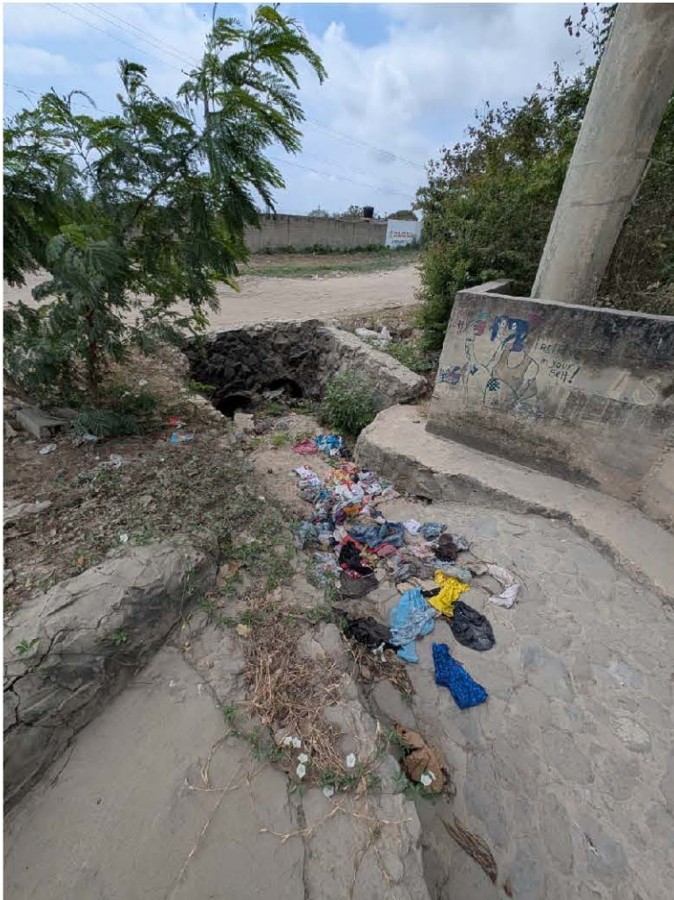
Foto 2. Canal de aguas pluviales con residuos sólidos ordinarios y acumulación de sedimentos, en el municipio de Soledad.
