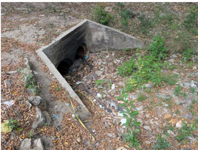
Foto 1. Canal de aguas pluviales con acumulación de sedimentos, en el municipio de Soledad.
